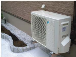
空調室外機設置状況
