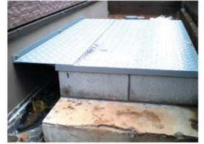
鍍鋼板の配管カバー
