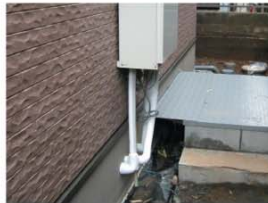
湯沸し器設置状況
