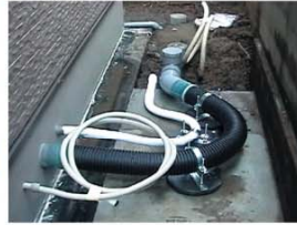
フレキシブル配管
